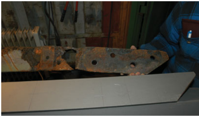
Bild 9. Ausgetauschtes, stark geschädigtes neben einem neu zu fertigendem Einzelprofil
