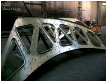
Bild 13. Verkleidungsblech Portalbogen nach der Instandsetzung Fig. 13. Casing panel of the portal frame after the restoration
