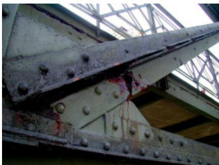
Bild 4. Rostschäden an einem Diagonalstab Fig. 4. Diagonal strut suffering from rust
