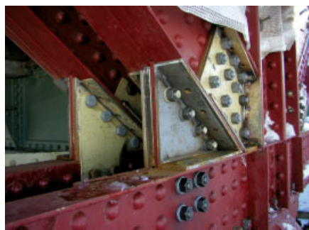
Bild 11. Pylonknoten mit Verstärkungen des Knotenblechs und der Fachwerkstäbe Fig. 11. Pylon nodal points with reinforcement of the gusset plate and the pin-jointed bars
