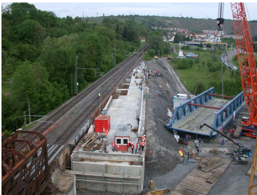
Abb. 1: Enzbrücke Besigheim mit „Brücke im Damm“ - Gesamtansicht der Bauarbeiten (Foto: DB Projektbau GmbH)
