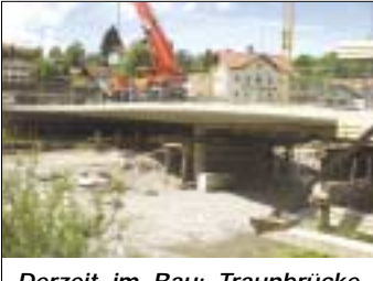
Derzeit im Bau: Traunbrücke Siegsdorf, Bauherr: Landkreis Traunstein, Entwurf, Ausschreibung und Oberbauleitung: Haumann & Fuchs.
